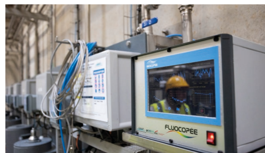
Test de prototype in situ (sonde Fluocopée) - Usine Seine aval
