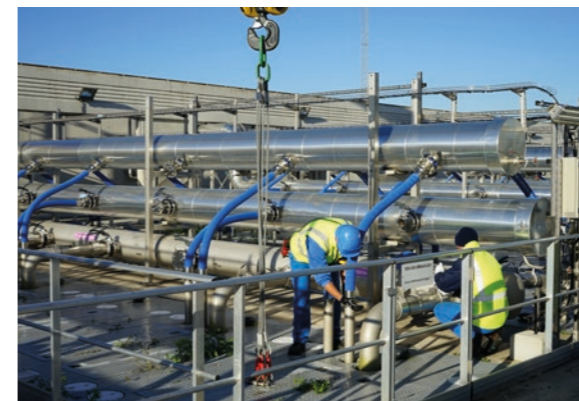
Traitement membranaire en assainissement - Seine aval
