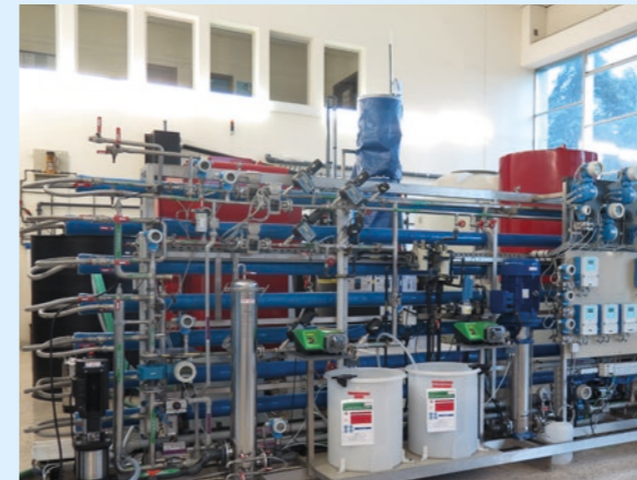
Pilote nanofiltration - Ville de Lausanne
